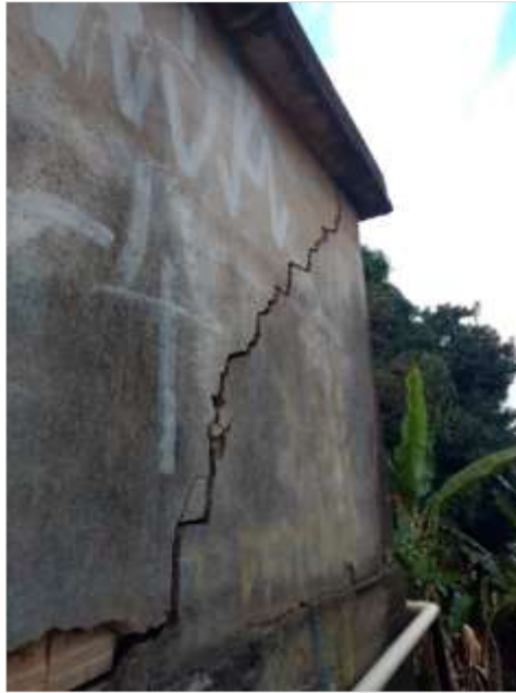
Figura 2 – Inspeção e avaliação de moradia em terreno com recalque diferencial.
