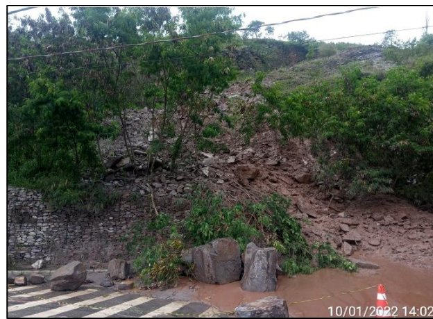
(b) Vista frontal do talude instável.
