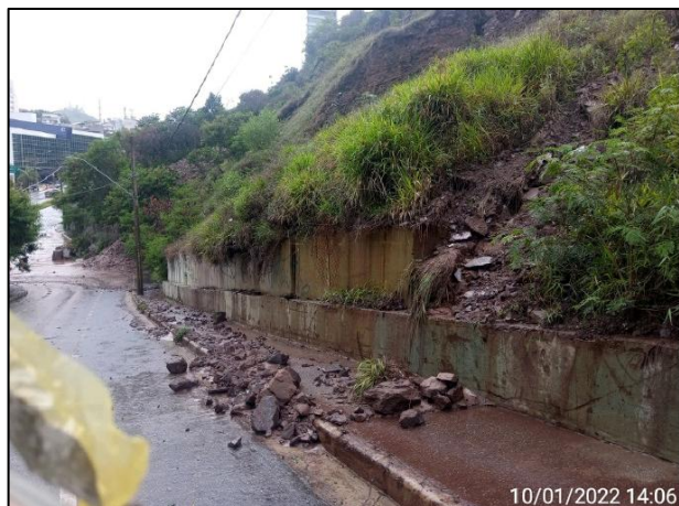
(a) Vista lateral do talude instável.
