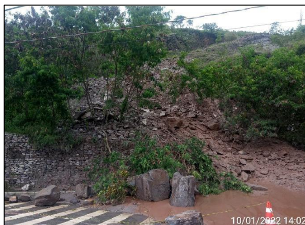
(b) Vista frontal do talude instável.
