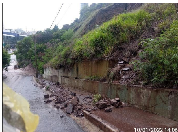
(a) Vista lateral do talude instável.
