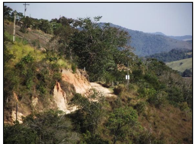
Fig. 19: Estrada apresentando sinais de deterioração acentuados, com destaque para a falta de obras de contenção das erosões.
